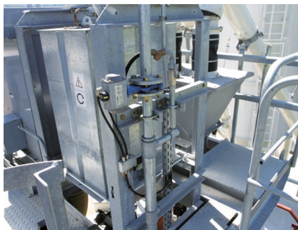
La plate-forme des bascules ciment et eau est largement dimensionnée et entièrement parcourable.
