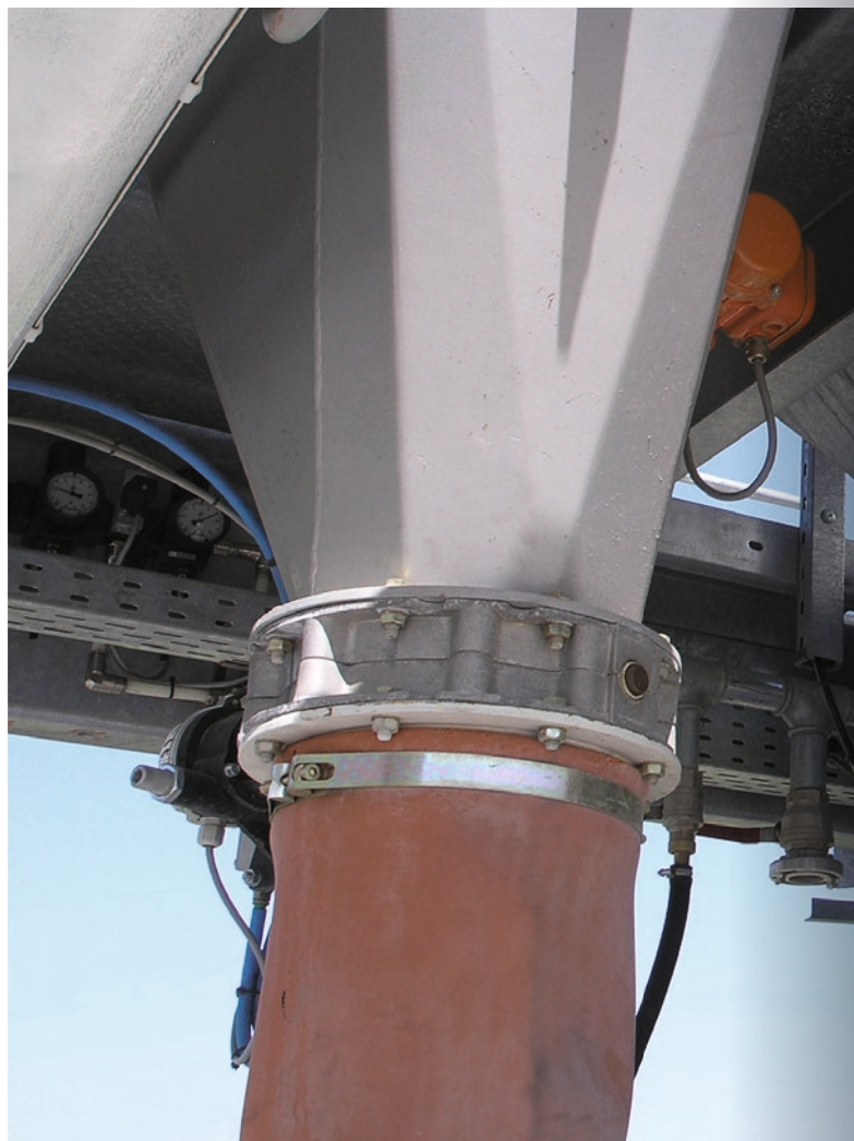
Système de pesage de grande qualité au-dessus de la plateforme malaxage.
