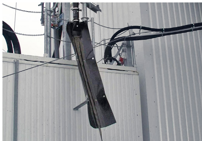
L'hydrocyclone L'hydrocyclone permet de réduire le taux de matières solides dans l'eau résiduaire.
