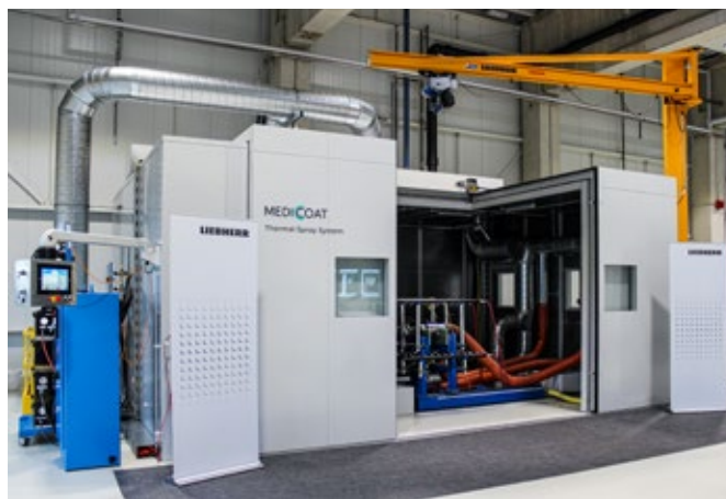
Application du procédé HVOF dans le nouveau bâtiment de Liebherr-Aerospace Lindenberg consacré au traitement de surface.
